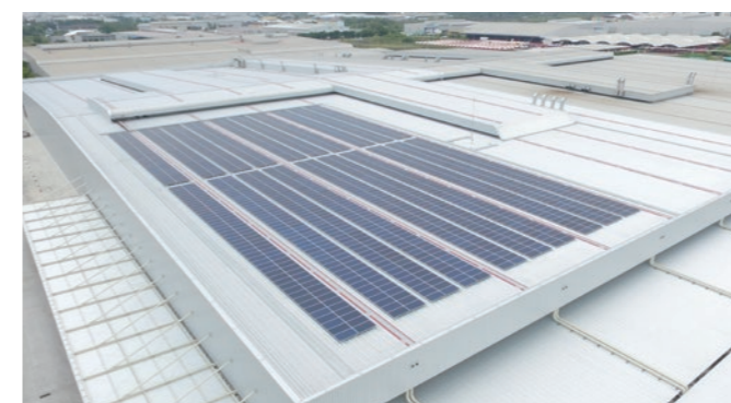
安装在屋顶上的光伏发电面板, 功率为510.3kW
