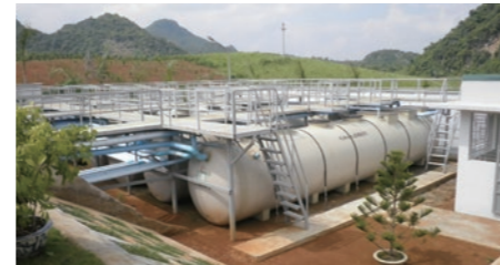
净化槽 在未完善下水道的地区进行污水处理。
