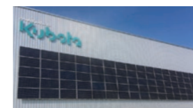
安装在墙面上的光伏发电面板, 功率为25.2kW
